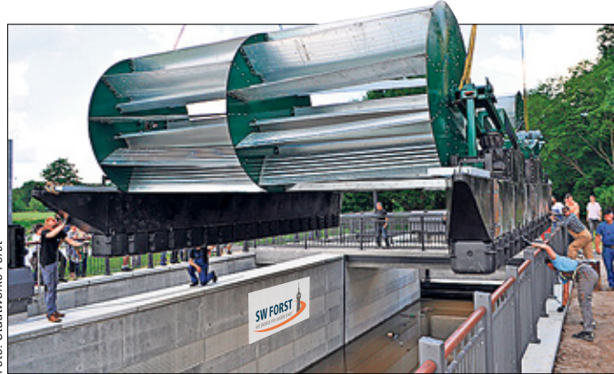
Neben den kommunalen Wasser- und Abwasserbetrieben stellen sich auch etliche Stadtwerke der Herausforderung zur verstärkten Nutzung Erneuerbarer Energien. Die Stadtwerke Forst beispielsweise kooperieren mit dem „Netzwerk Technologiekompetenz Fluss-Strom“ und testen einen „River Rider“ als schwimmendes Kraftwerk zur Energieerzeugung in der Neiße-Strömung.
