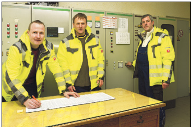
Die Kollegen Ronny Schober, Ralf Thomas und Dirk Leipner (v. l. n. r.) in der Schaltzentrale der Verbandskläranlage in Beeskow.
