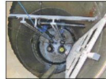
Eins der 42 Hauptpumpwerke des Verbandes.
