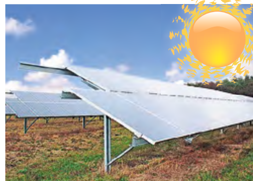
Mit Sonnenenergie wird tagsüber die Kläranlage betrieben.
