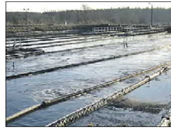
Belebungsbecken der Kläranlage Beeskow.
