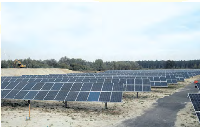
Eine zuverlässige Mitarbeiterin ist die Sonne. Sie versorgt die Solaranlage des WAZV, die direkt bei der Kläranlage Beeskow installiert ist.
